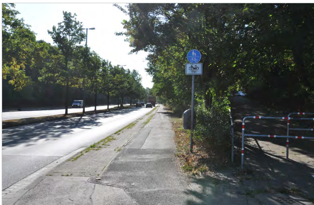
Sanierungsbedürftiger Geh-/Radweg Bornumer Str. zwischen Beckstr. und Ossietzkyring (Büro für Freiraum- planung Christine Früh)
