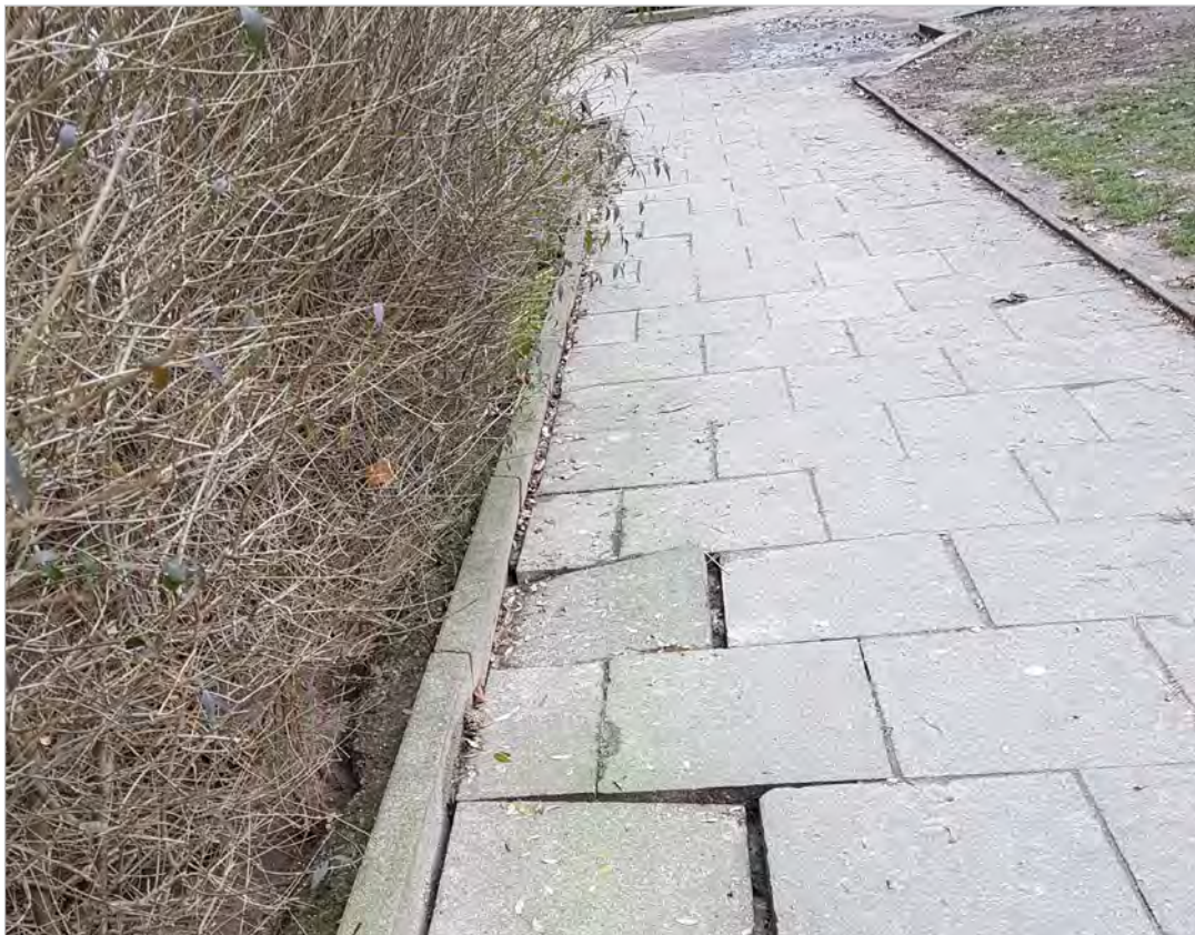
Schadhafte Zuwegung auf privater Fläche zu Hauseingängen Canarisweg (LHH)
