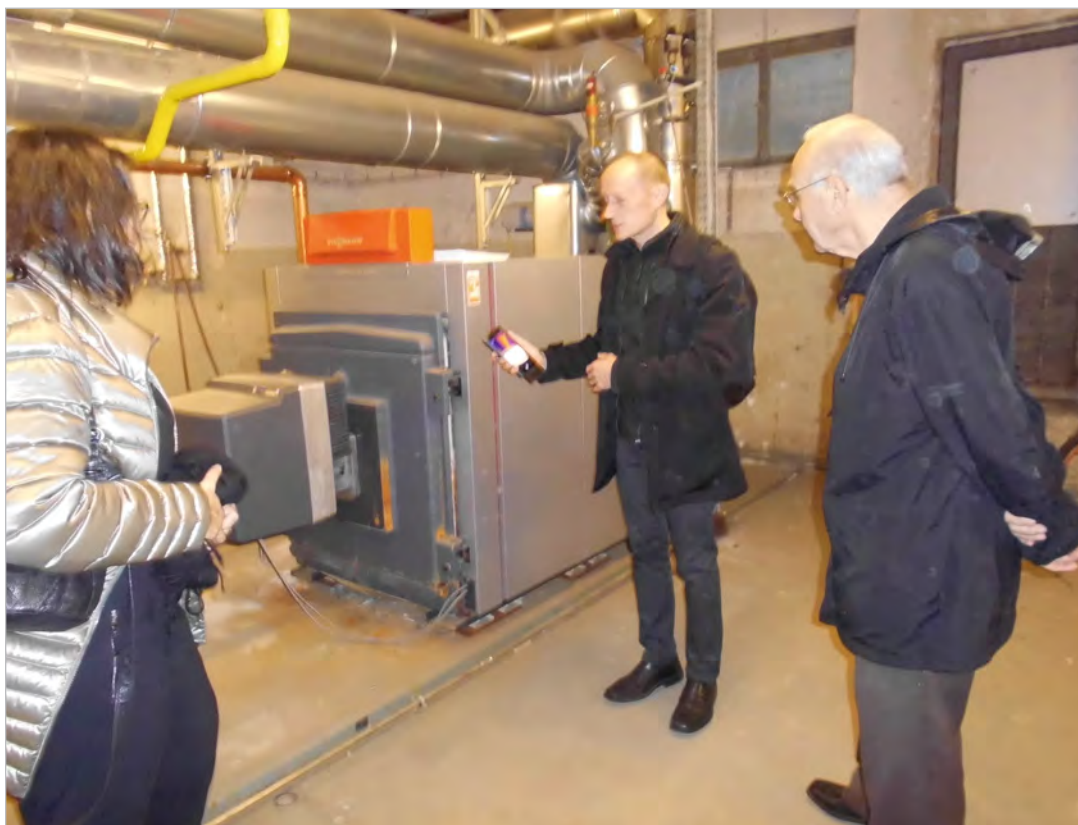
Aufspüren von Wärmeverlusten, Heizungsanlage Grundschule Mühlenberg (LHH)
