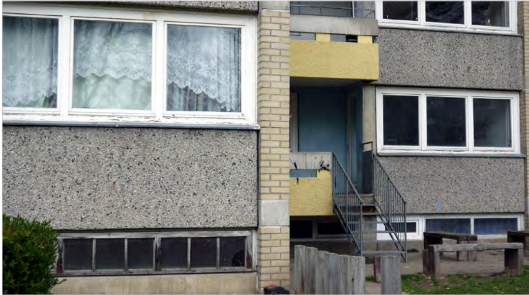
Sanierungsbedürftige Wohnungsbestände Canarisweg (LHH)
