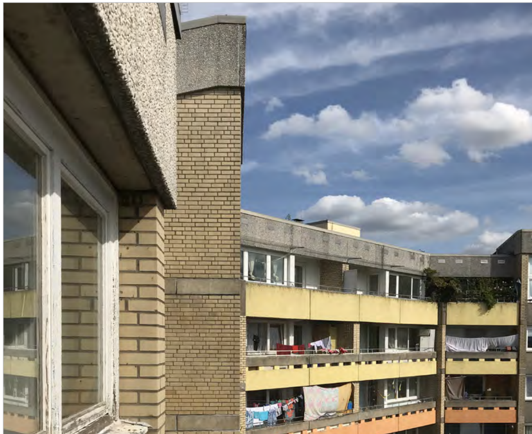
Sanierungsbedürftige Bestände Canarisweg (LHH)
