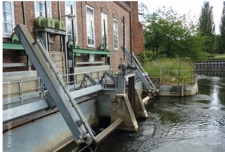
Wasserkraftwerk „Schneller Graben“
