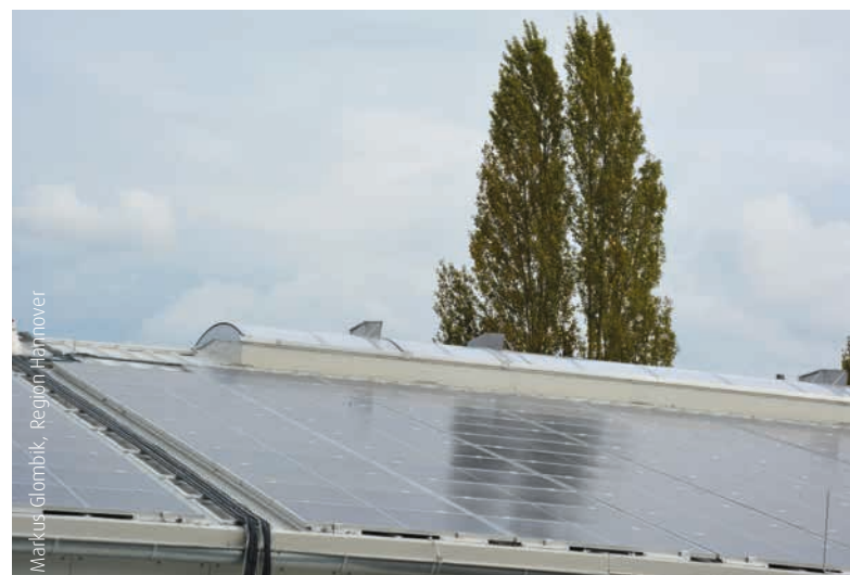
Die von der AG Energieversorgung im September 2017 besichtigte PV-Anlage am energycity-Innovationsstandort in Hannover-Herrenhausen
