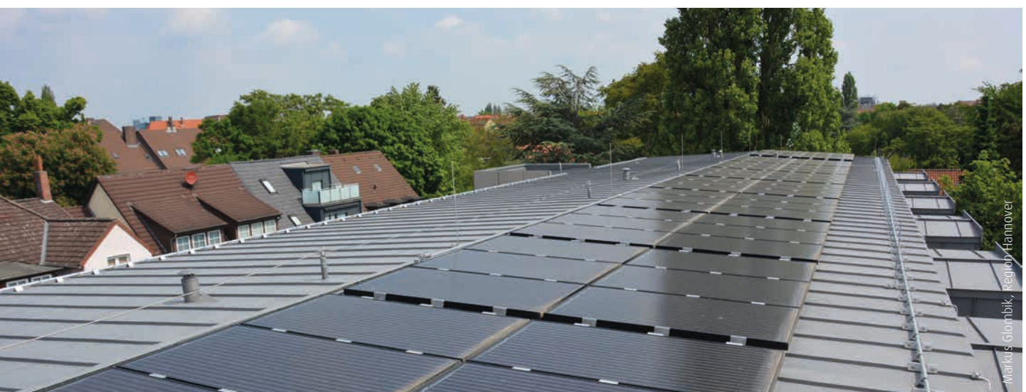
Photovoltaikanlage auf dem Gesundheitsamt der Region Hannover in der Weinstraße
