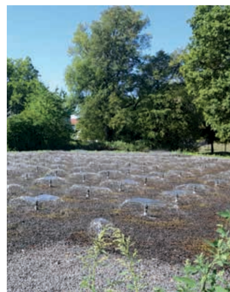
Der große, pflegeleichte „Neptunfilter“ sorgte den ganzen Sommer über für beste Wasserqualität in den Becken.
