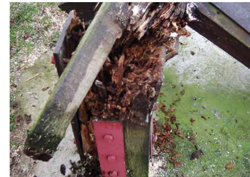
Aussichtsturm: Das Ständerwerk ist durch Pilzbefall zerstört
