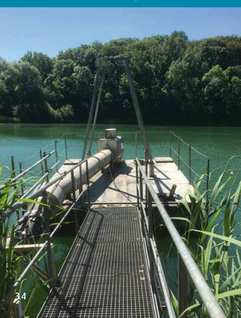
Wasserentnahmestelle aus einem Oberflächengewässer
