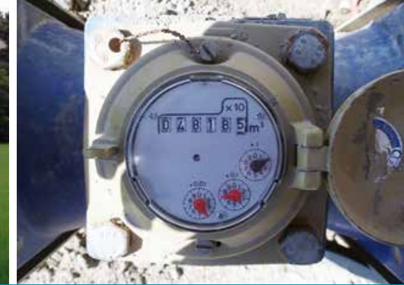
Die entnommenen Wassermengen müssen über Wasserzähler erfasst werden
