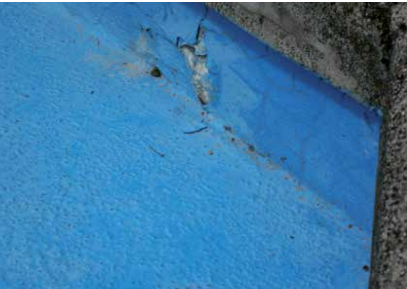
Durch Alterung und Frosteinwirkung abblätternde Schwimmbadfarbe
