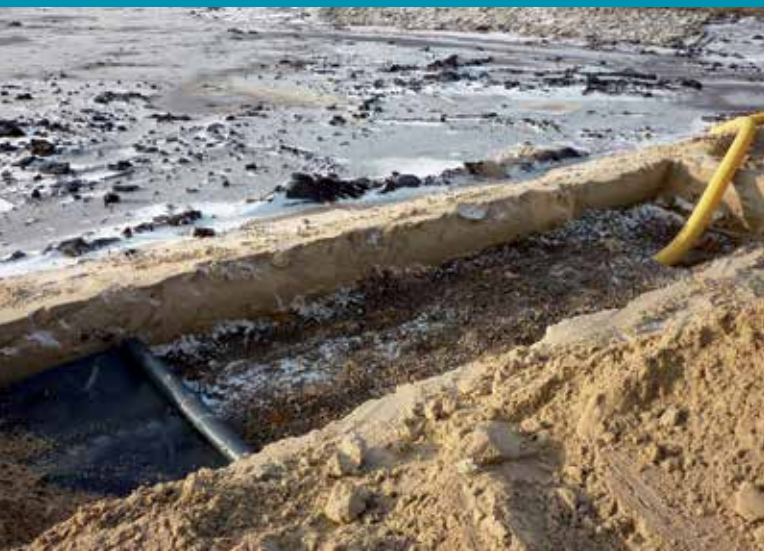
Ein Kies-Bodenfilter wird zur Reinigung des Regenwassers eingesetzt
