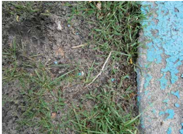
Abblätternde Schwimmbadfarbe und grobe Farbpartikel auf dem angrenzenden Boden
