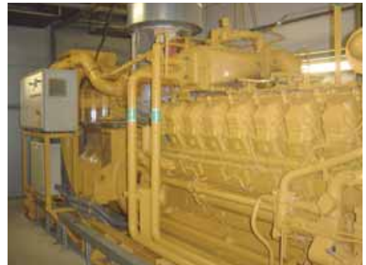
BHKW Modul | CHP module
