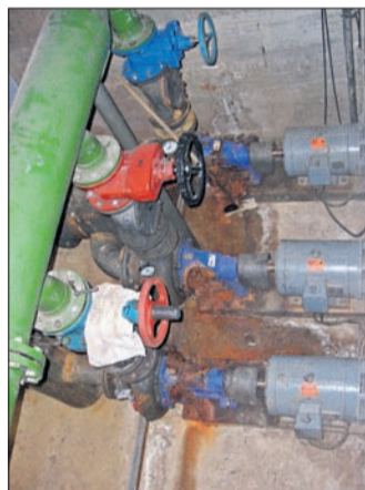
Erneuerungsbedürftig: Die alten Umwälzpumpen im Volksbad Limmer.
