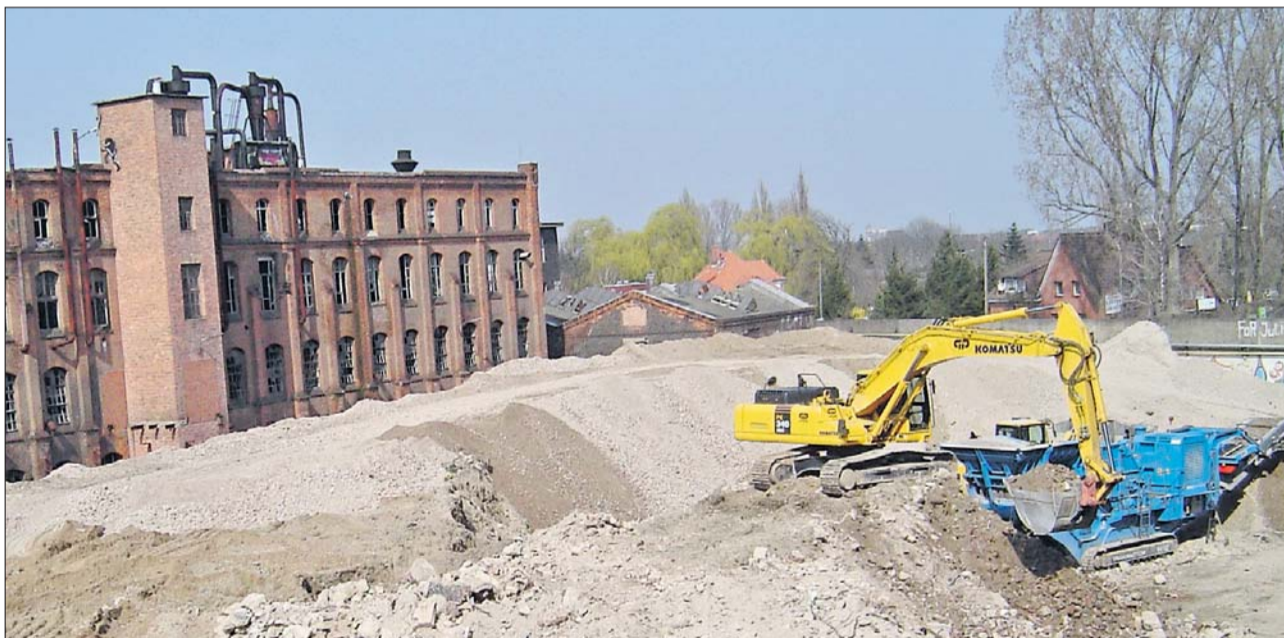
Arbeiten auf dem Conti-Gelände: Im Vordergrund ist eine Maschine zu sehen, die Abrissmaterial zerkleinert und für eine weitere Verwendung vorbereitet.
