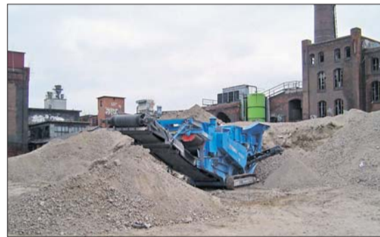
Unbelastetes Abbruchmaterial wird geschreddert und als tiefliegende Basisschicht wieder auf dem Gelände verbaut.
