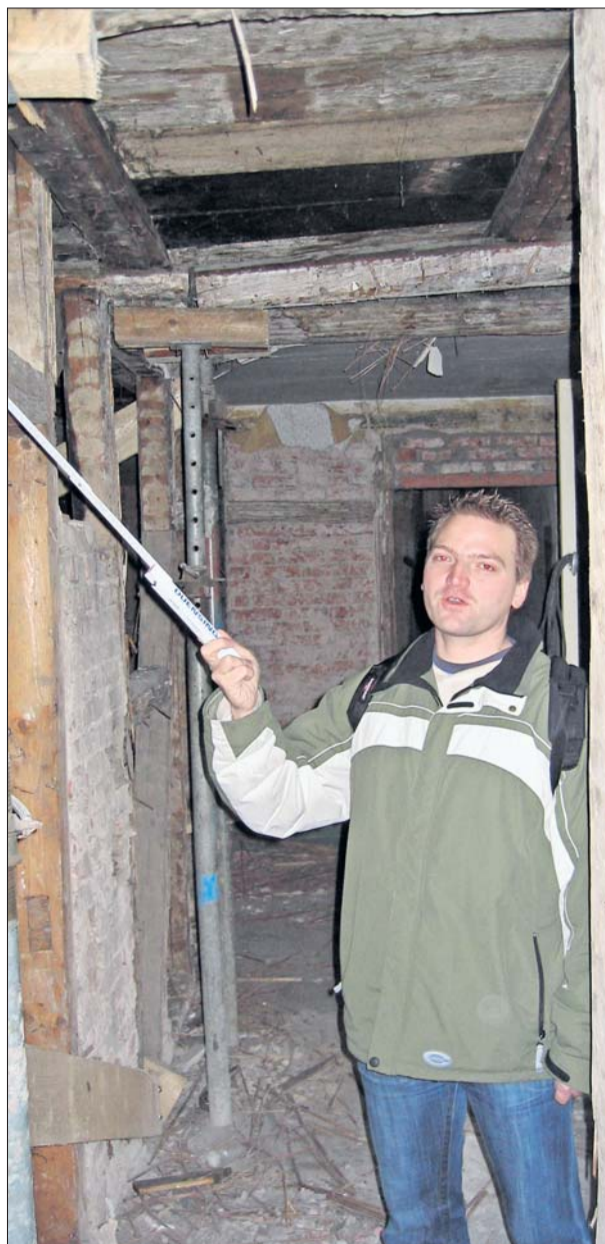
Architekt Frank Bolte hätte gern mehr von der ursprünglichen Bausubstanz erhalten. Die mangelhafte Statik spricht dagegen.
