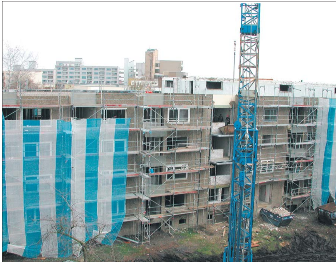
Komplett saniert: Derzeit werden die Häuser Sahlkamp 81 und 83 von innen und außen modernisiert. Nach dem Umbau erhalten sie mit der Magdeburger Straße 2 und 4 auch eine neue postalische Adresse.
