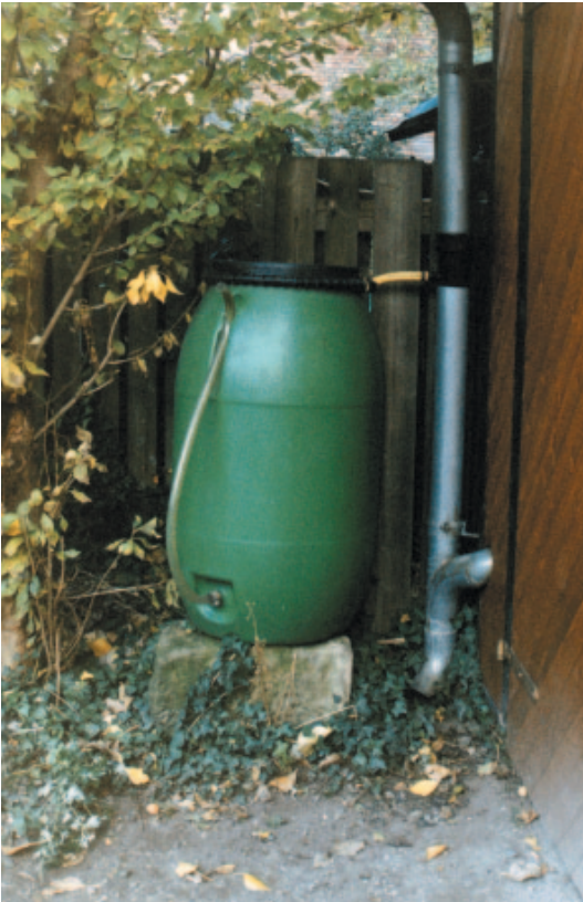
Bild 5: Zwischenspeicherung über Regenwassertonne
